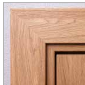
standardowe łączenie opasek pod kątem 45°
